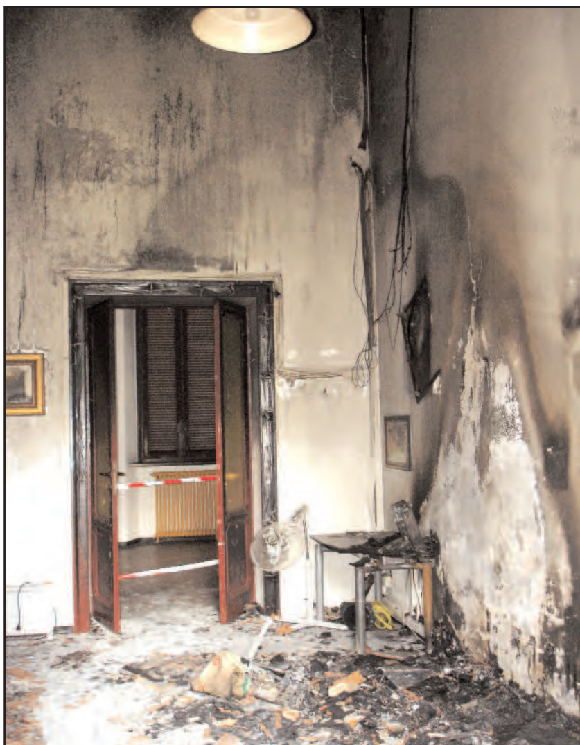
L'interno della segreteria dell'ufficio del sindaco devastato dall'attentato incendiario eseguito nella notte tra giovedì 22 e venerdì 23 settembre
